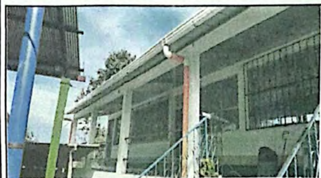
Foto 3: Sustrución de Canales y bajadas de agua pluvial fronto al establecimiento.
